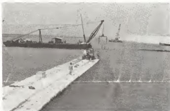
E trabaoan di construcion di e Containerhaven ta hopi avansa y ta ser spera cu pa otro aña, e proyecto lo keda finalisa.
